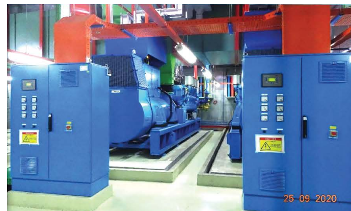
Trung tâm dữ liệu FPT Telecom
