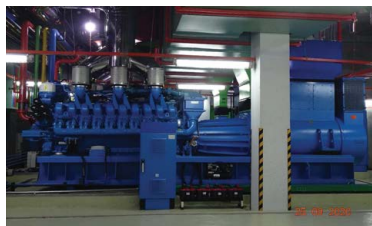
Trung tâm dữ liệu FPT Telecom
