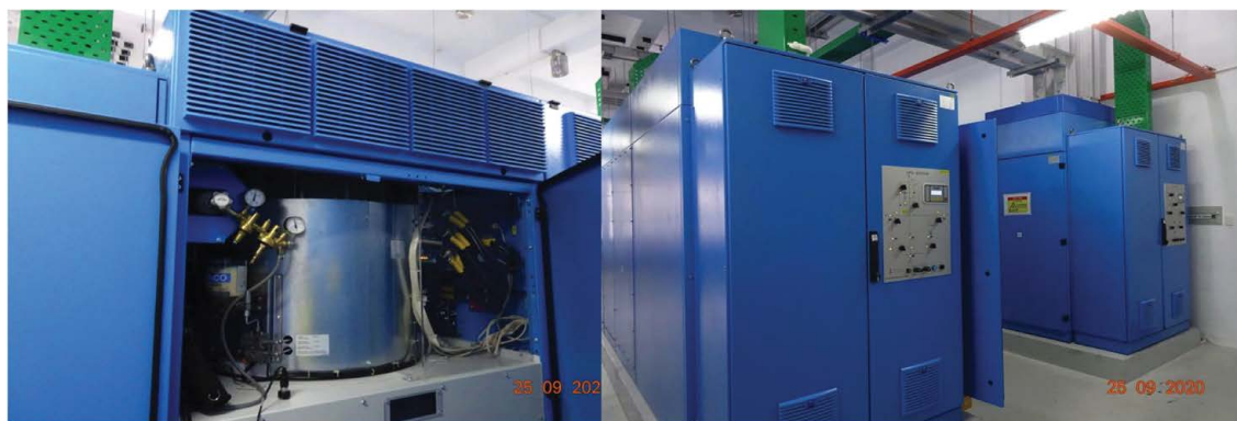
Trung tâm dữ liệu FPT Telecom
