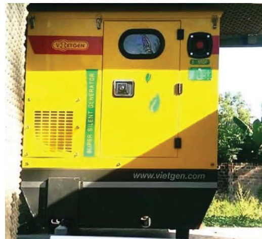
Trạm viễn thông BTS
