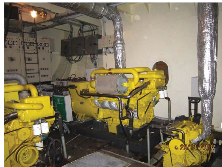
2 tổ máy phát điện 350kVA
