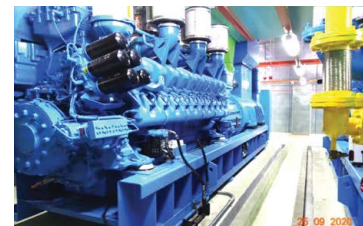
Trung tâm dữ liệu FPT Telecom
