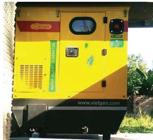
Trạm viễn thông BTS
