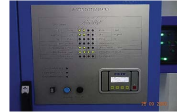
Trung tâm dữ liệu FPT Telecom
