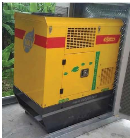
Trạm viễn thông BTS
