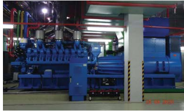
Trung tâm dữ liệu FPT Telecom
