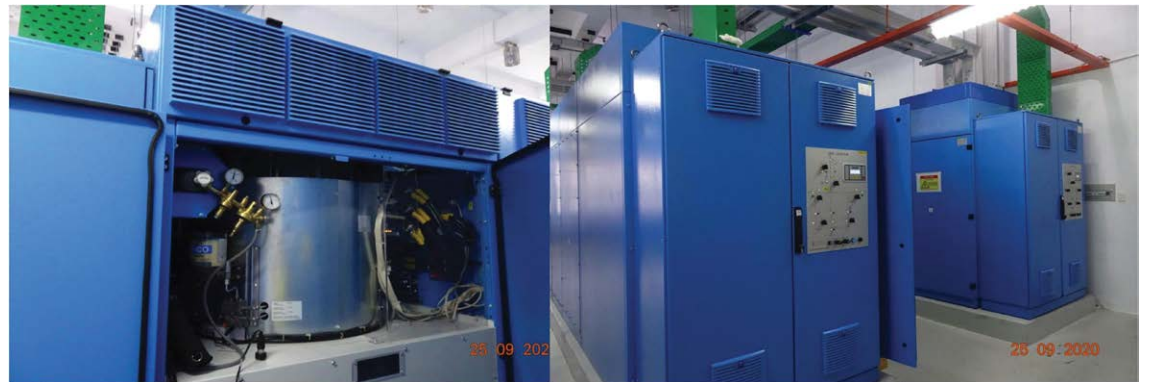
Trung tâm dữ liệu FPT Telecom
