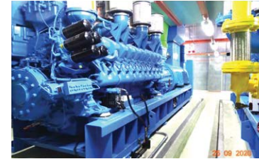
Trung tâm dữ liệu FPT Telecom
