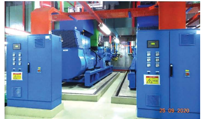
Trung tâm dữ liệu FPT Telecom
