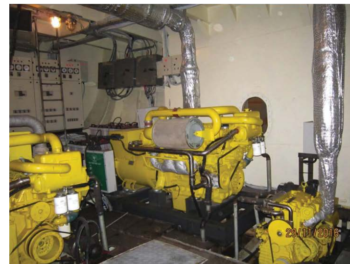
2 tổ máy phát điện 350k VA
